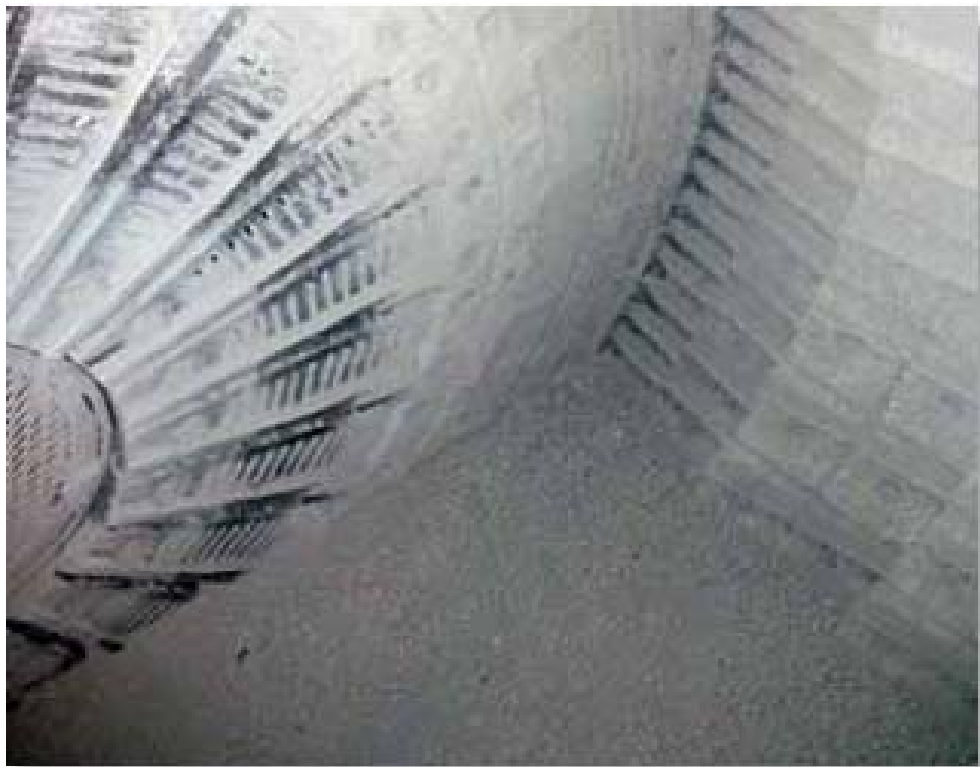
Hình 7: Đầu ra máy nghiền bị nghẹt do cấp liệu quá thừa
